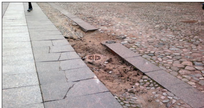
Рис. 5. Мощение, примыкающее к элементам водосборной системы (водосточные трубы, лотки и т. д.) легко размывается водой
