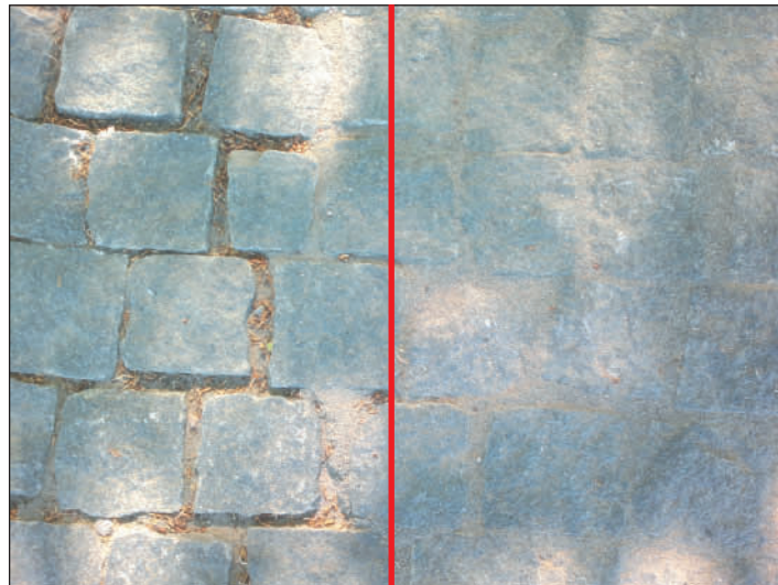
Рис. 77 (б). Швы с заполнением песком (традиционное исполнение, левая часть снимка) и растворами на основе вяжущих (правая часть снимка). Лето 2014 г.
