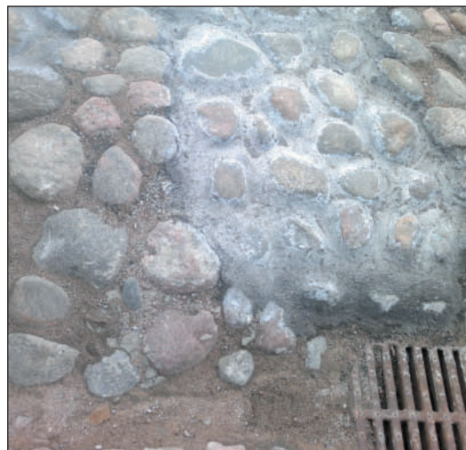
Рис. 24. Нарушение эстетического вида мощения вследствие нарушения технологии выполнения работ (Петропавловская крепость, Санкт-Петербург, 2015 г).
