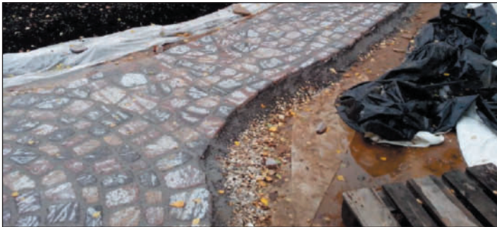
Рис. 31. Отсутствие воздушного зазора между урывочным материалом и мощением привело к образованию белых налетов на покрытии.
