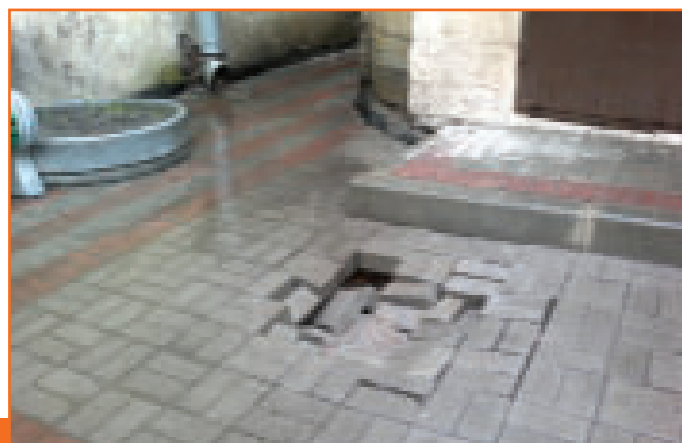
Разрушение мощения из-за неправильно организованного водоотвода
