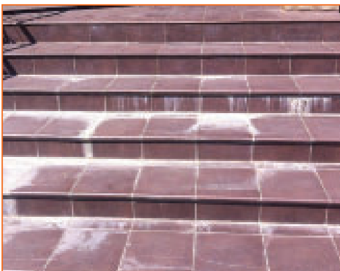
Высолообразование на поверхности облицовки портит эстетический вид
