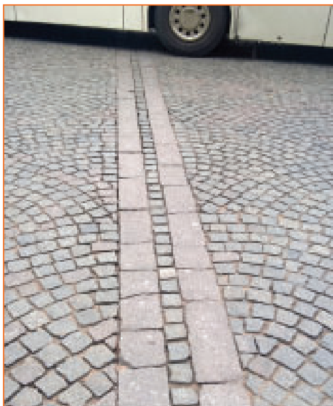
Разрушение плит мощения в зоне проезжей части
