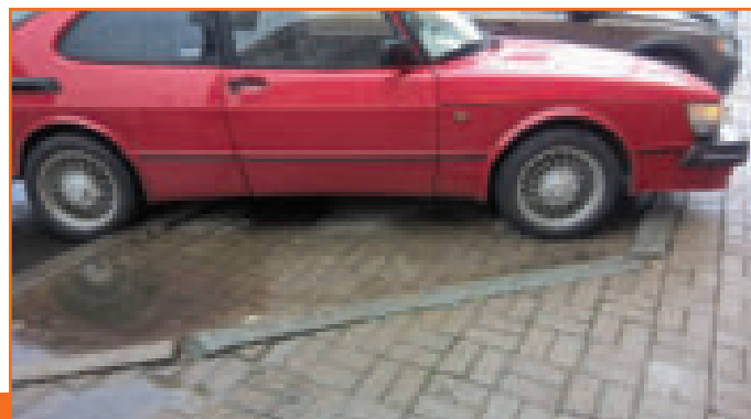
Деформация дорожного покрытия из бетонных камней на автомобильной парковке
